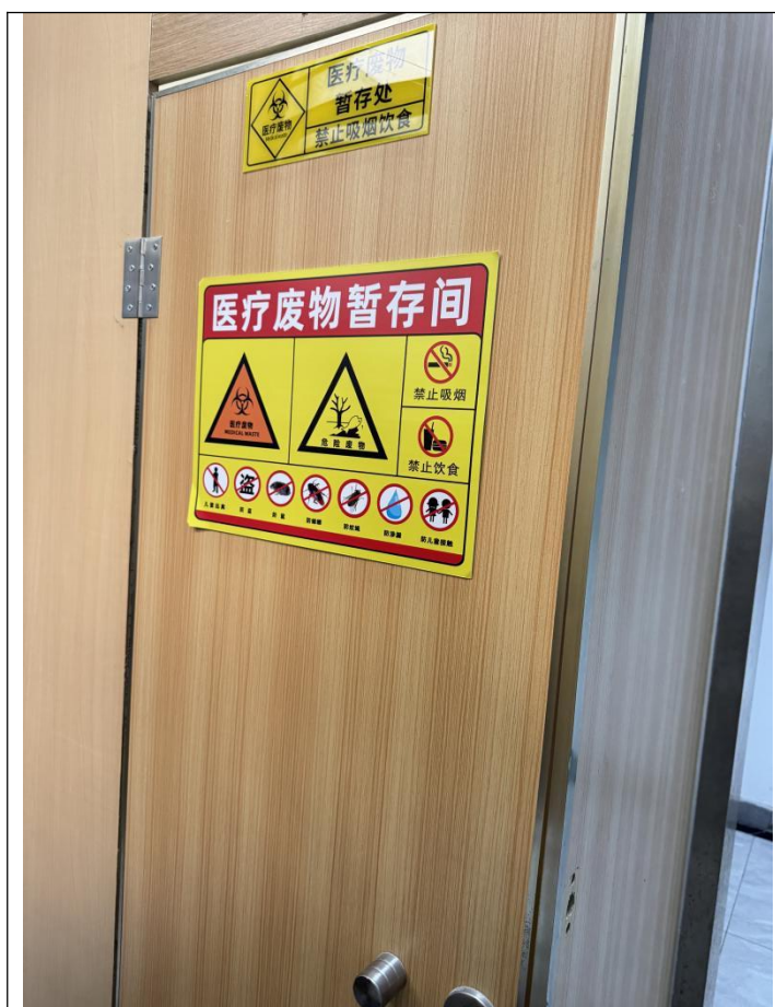
图 4-3 现有危废间治理设施图
